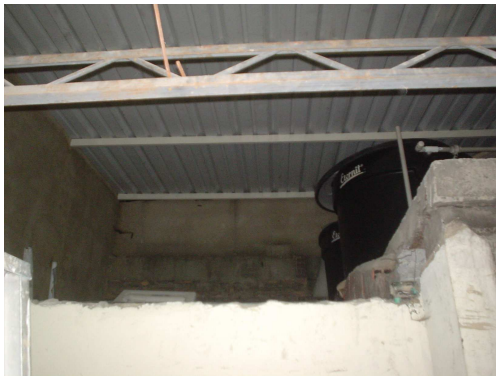
TANQUES DE AGUA UPA LORENCITA
